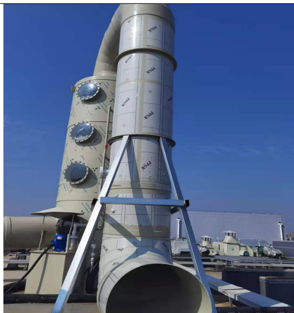
水洗塔+排气口
